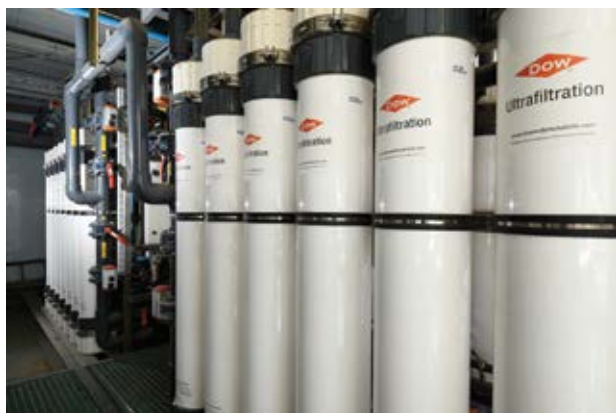
廢水處理及回收設施升級項目耗時三年完成，令廠房的廢水回收率從35%提升至介乎50-54%之間。
