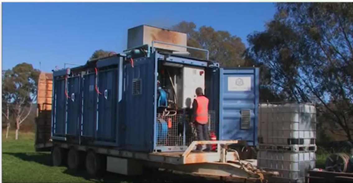
生物炭機及冷卻裝置
