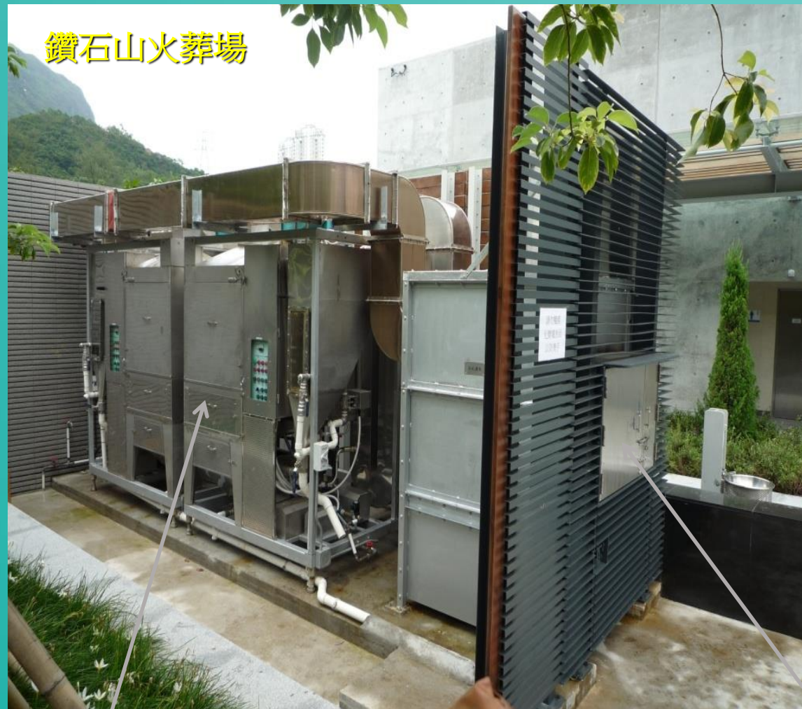
兩組「清煙」除煙裝置
